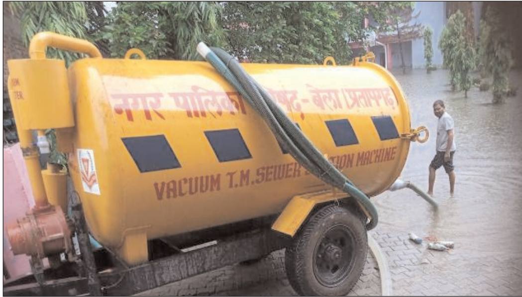
मशीन लगाकर जलभराव का पानी निकालते नगर पालिका कर्मों
