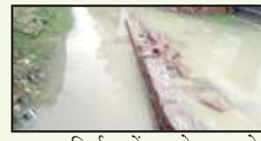
सड़क निर्माण में अवरोध डालने के बाद क्षतिग्रस्त सड़क।
