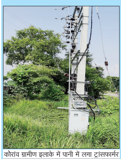
कोरांव ग्रामीण इलाके में पानी में लगा ट्रांसफार्मर
