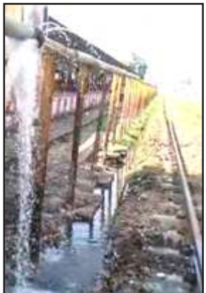
पांच नंबर प्लेटफार्म के बगल पांच नाले का पानी।
