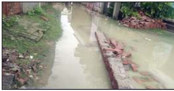
स्कूली बच्चों द्वारा तोड़ी गई नगर पालिका की निर्माणाधीन सड़क।
