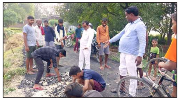
बजहा गांव के बीच बन रही घटिया सड़क निर्माण को देखते ग्रामीण।
